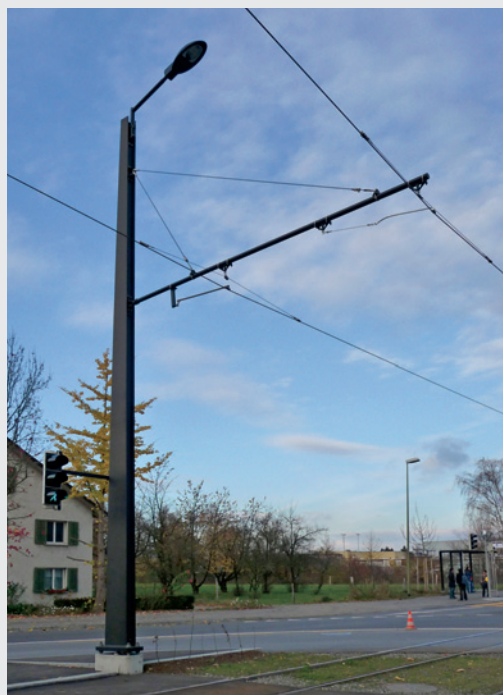
Abbildung 3: Der Fahrleitungsmast der Glattalbahnen
