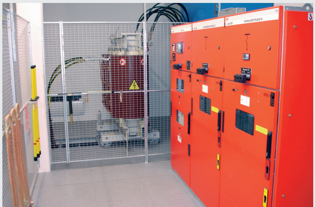
Abbildung 1: Bahntransformator (Mitte) und Mittelspannungsanlage (rechts)
