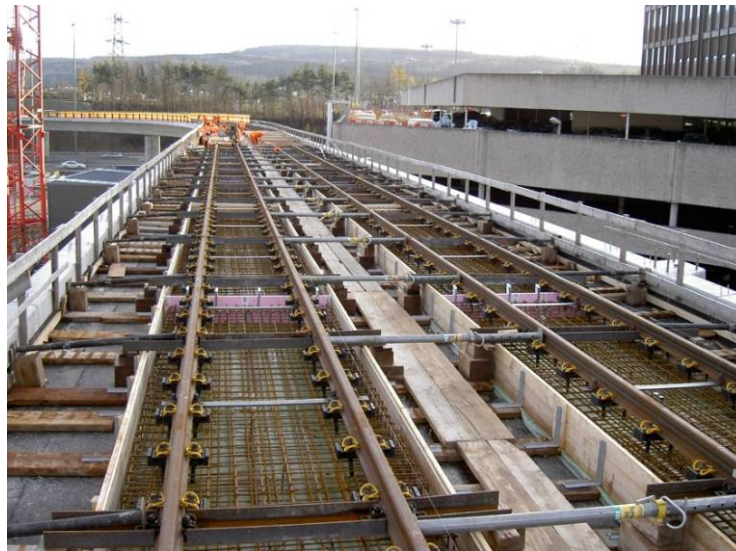
Abbildung 15: Gleis auf dem Viadukt Glattzentrum vor dem Betonieren der Gleistragplatte in Top-Down-Bauweise
