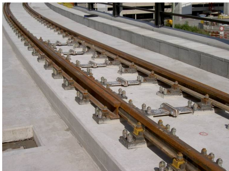
Abbildung 9: Schienenauszug Viadukt Glattzentrum mit besonderen Schienenbefestigungen
